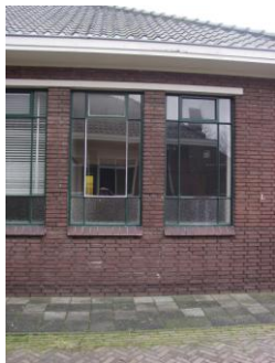
foto 1: stalen kozijnen en ramen
