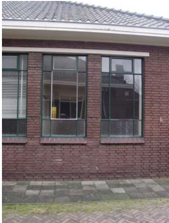
foto 1: stalen kozijnen en ramen
